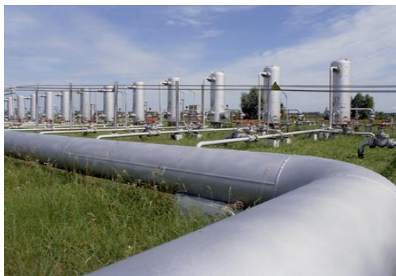
Низкое давление, большой поток
