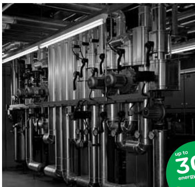
Управление насосной станцией
