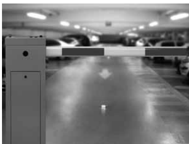
Шлагбаум, управляемый ПЧ ATV 12
